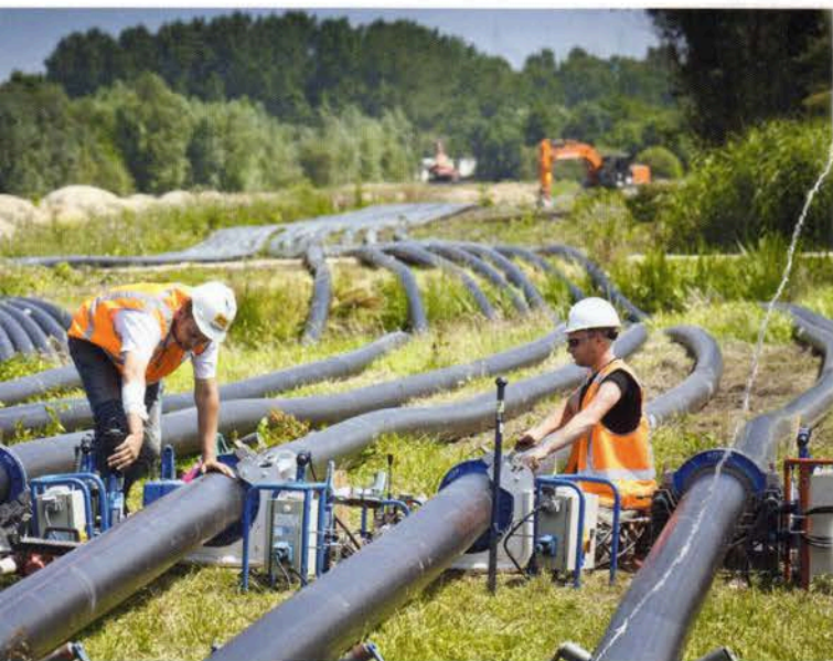
Abb. 3 – An den sogenannten „Muffenstellen“ werden die einzelnen Abschnitte des Hochspannungskabels im Feld mit einer Kabelmuffe verbunden. Bei der Kabelverlegung wird nicht mit Endloskabeln gearbeitet. Die Länge eines Abschnitts eines 150-kV-Kabels beträgt ungefähr 1.400 m, bei 380 kV sind es nur ca. 1.000 m. Das liegt am Gewicht des Kabels. Für lange Verbindungen sind also Kabelmuffen erforderlich.
