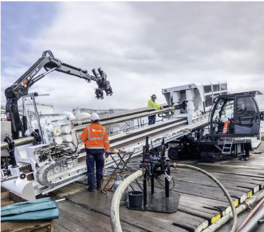
Umweltfreundlich, kompakt, leistungsstark: die neu entwickelte voll elektronische Bohranlage PD 300-120 E von Prime Drilling im Arbeitseinsatz | Fotos: Prime Drilling
