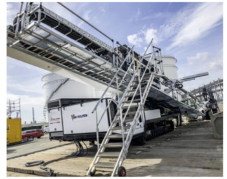
Ein verbreiteter Laufsteg mit Treppe und Arbeitspodest dient der Sicherheit.
